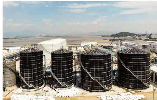
SINOPEC Petroleum WWTTP
